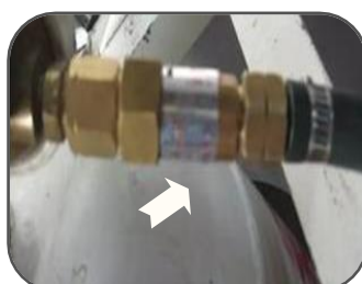
② 气瓶应有防回火装置
